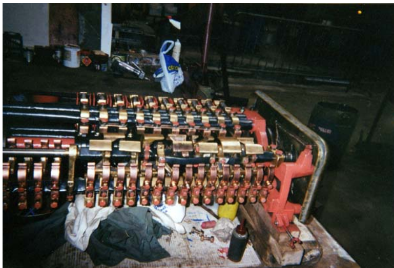
Le voici maintenant complètement câblé.
